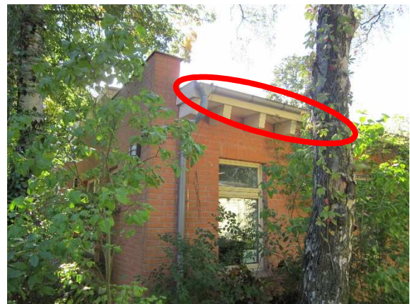
Abb. 3: Nordseite Hansastrasse 182a: Bereich zur Anbringung eines Nistkastens für Hausrotschwanz
